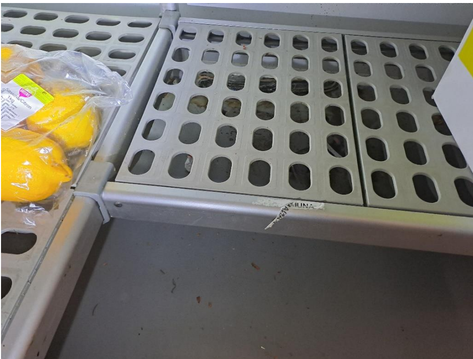
Kuva 2. Kellarin kylmähuoneen lattia oli likainen. Hyllyn alla oli täysin mädäntynyt kurkku.
