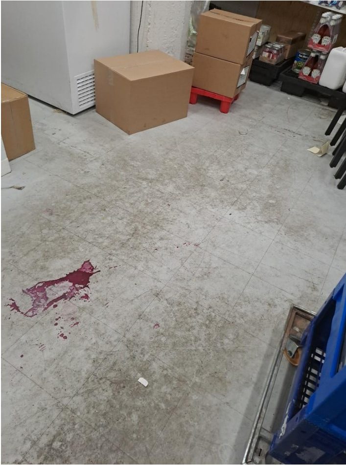
Kuva 1. Kellarin varaston lattia on likainen.
